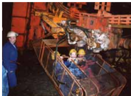
Aufbruchbühne zur Überföhrung von Überhauen
