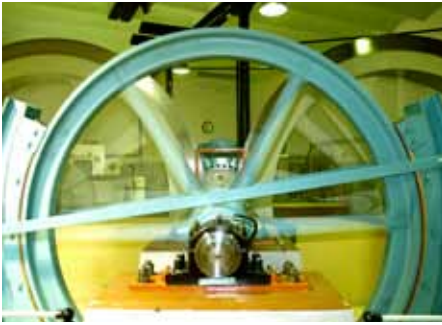
Antriebseinheit der Standseilbahn
