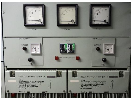
Transvertergestell, Teilansicht, unten mit zwei Stromversorgungsgeräten B 1653.1
